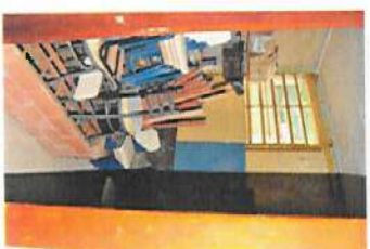
SITUAÇÃO ENCONTRADA EM 2015
