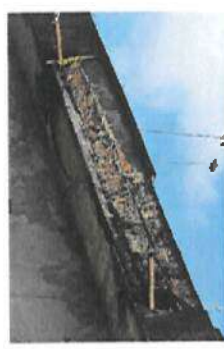
DESPRENDIMENTO ARGAMASSA S1
