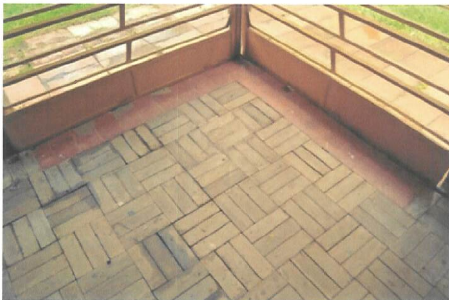
SITUAÇÃO ENCONTRADA em 2015
