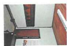
SITUAÇÃO ENCONTRADA EM 2015
