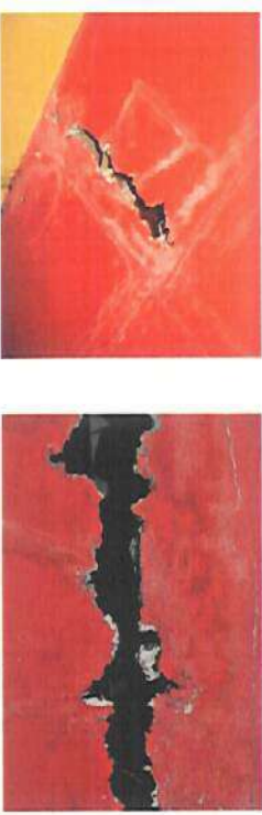
DETALHE DO ESTADO ATUAL DE COMPROMETIMENTO DO ESTUQUE DE GESSO.
