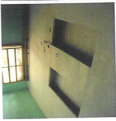
SITUAÇÃO ENCONTRADA EM 2015
