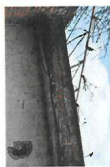
DESPRENDIMENTO DE ARGAMASSA D2
