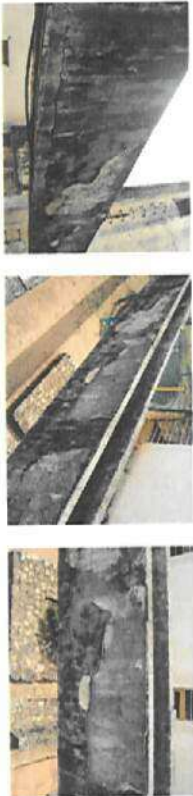
VIGAMENTO DA FLOREIRA COM DESPERDÍCIO DO REVESTIMENTO EM ARGAMASSA
