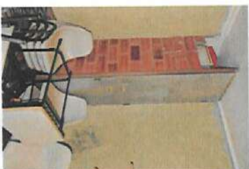
SITUAÇÃO ENCONTRADA EM 2015
