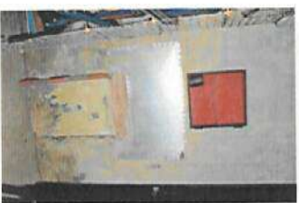
SITUAÇÃO ENCONTRADA EM 2015
