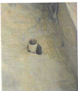
CONDUTOR DE AP ENTUPIDO
