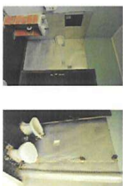
SITUAÇÃO ENCONTRADA EM 2015
