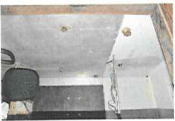
SITUAÇÃO ENCONTRADA EM 2015
