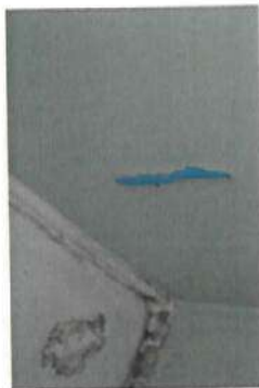
Detalhe da pintura PVA deslocando.
