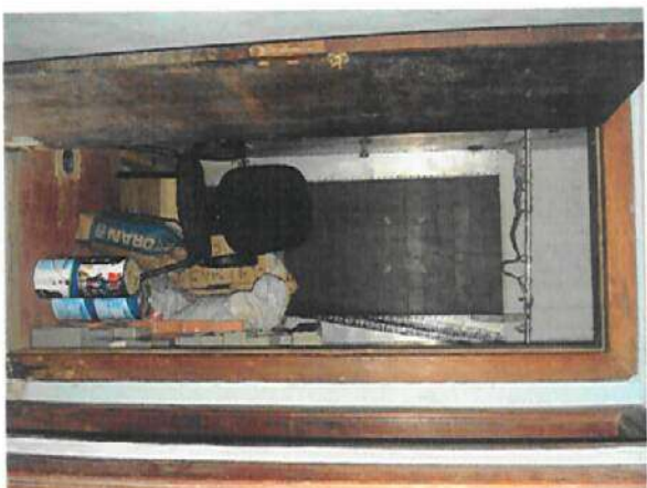
SITUAÇÃO ENCONTRADA EM 2016
