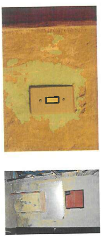
INTERRUPTOR D1 PIA
